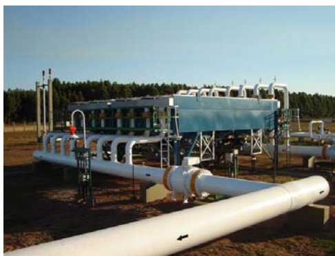
Aeroenfriadores de gas Pta. TC Pichanal (TGN SA)
