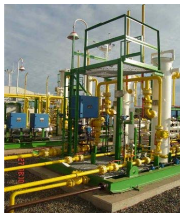
Equipo paquetizado del Sistema de Gas Combustible Pta. Compresora (TGN SA)
