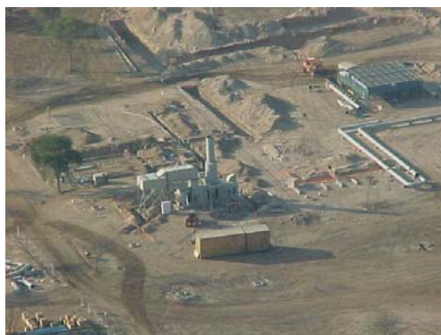
Turbocompresor Solar Taurus 70 SoLoNox Planta Lumbreras (TGN S.A.) Salta
