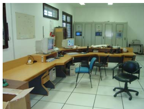
Sistema de Control Planta Pichanal (TGN S.A.)
