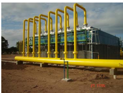
Aeroenfriadores de Gas en Ptas Compresoras Lumbreras, Deán Funes, Lavalle y Recreo.
