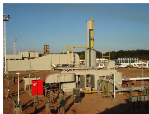
Turbocompresor Solar T-60 Pta Pichanal (TGN SA)
